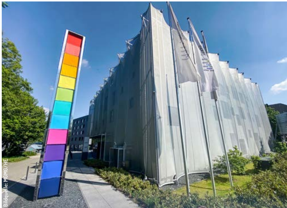
Für das Großprojekt Textilfabrik 7.0 soll ein umfangreiches Netzwerk sowie ein der T7 Park als passender Gewerbepark entstehen. Zum Netzwerk gehört auch die Textilakademie.
